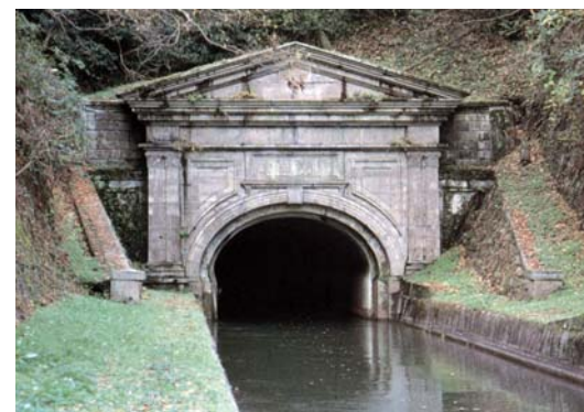
●琵琶湖疏水石工事 三代目茂右衛門は京都の産業振興の動力源となった琵琶湖疏水の建設にも参加した。写真は明治23年につくられた疏水門
